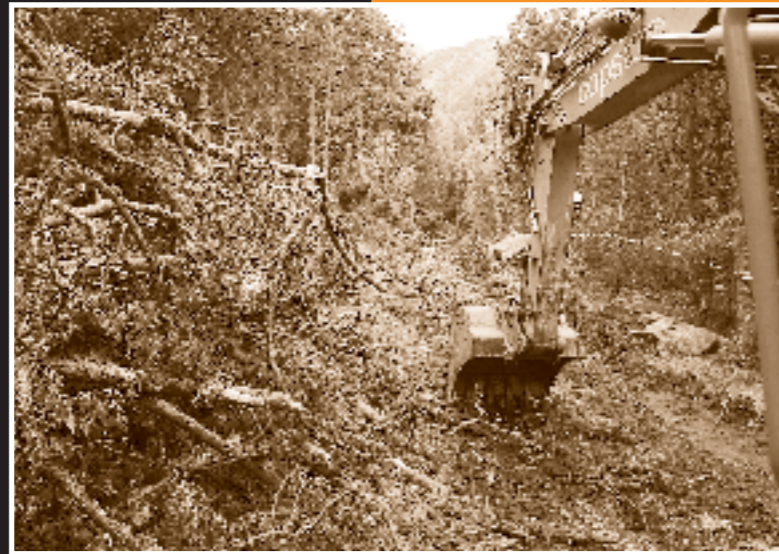
La captació d'aigua per a la macroubanització de Sant Pere, al Serrat, ha portat al Comú d'Ordino a destrossar l'entorn de la Font dels Cuiners, al costat mateix del Parc Natural de Sorteny. Foto: Xavier Pujol.
